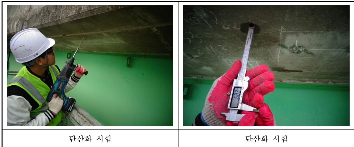
〈사진 3.24〉 탄산화 현황
